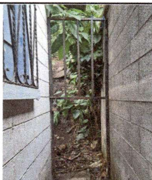
Foto 3: Sustrucción de puerta
